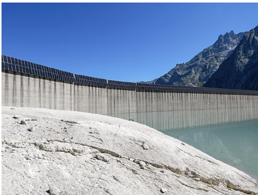
Im Bergell hat die ewz die erste PV-Anlage der Schweiz an einer Staumauer verwirklicht (Bild: © ewz)
