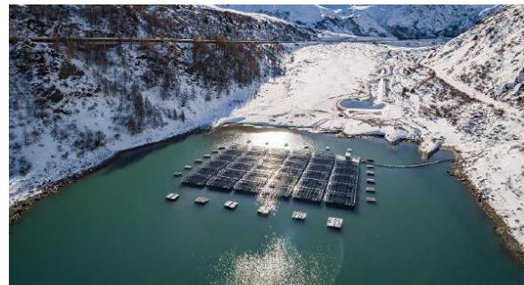
Auf dem Lac de Toules wurde die erste schwimmende PV-Anlage der Schweiz verwirklicht (Bild: © ewz)
