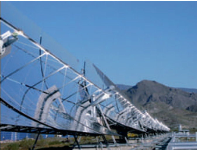
4.15 Parabolrinnenkollektoren, wie sie auch in Kalifornien verwendet werden. Die Einfallende Sonnenstrahlung wird auf die Röhre in der Mitte gespiegelt. Dort wird die Trägerflüssigkeit auf mehrere Hundert Grad erhitzt und betreibt anschliessend ein konventionelles Dampfkraftwerk.
