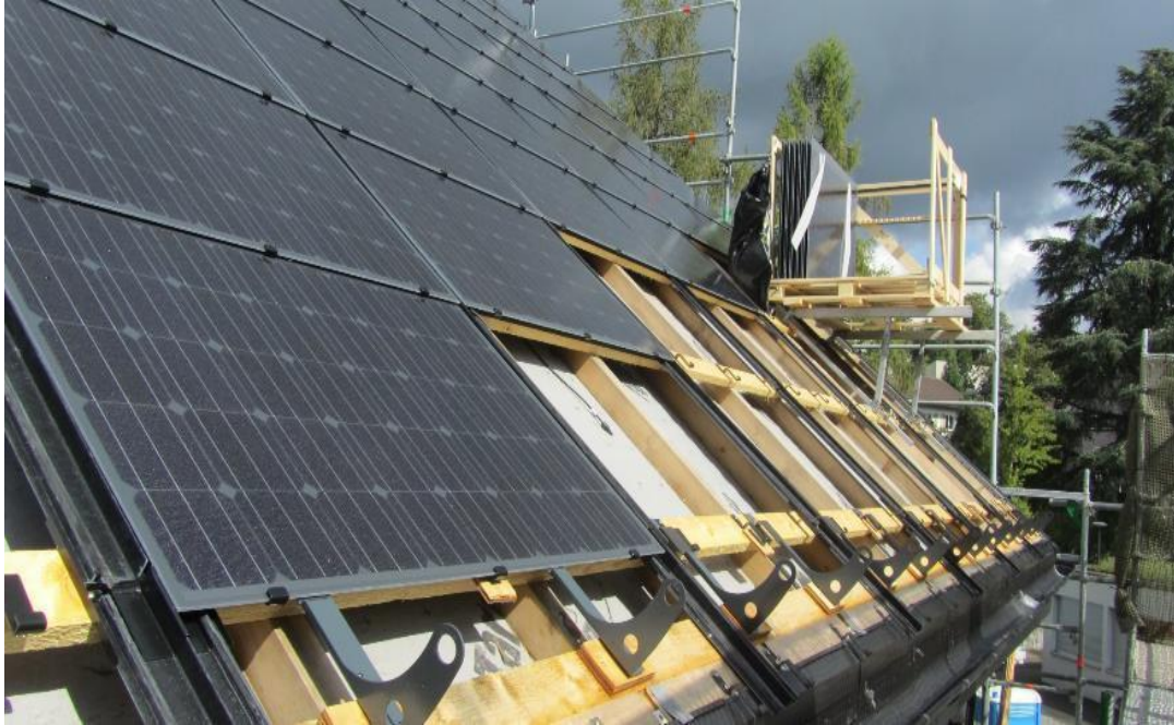
Schrägdach mit Montagesystem Dachintegriert (Ersatz Ziegel)
