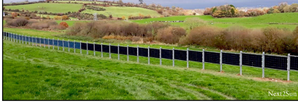
Bifaziale Solarmodule als Zaun
