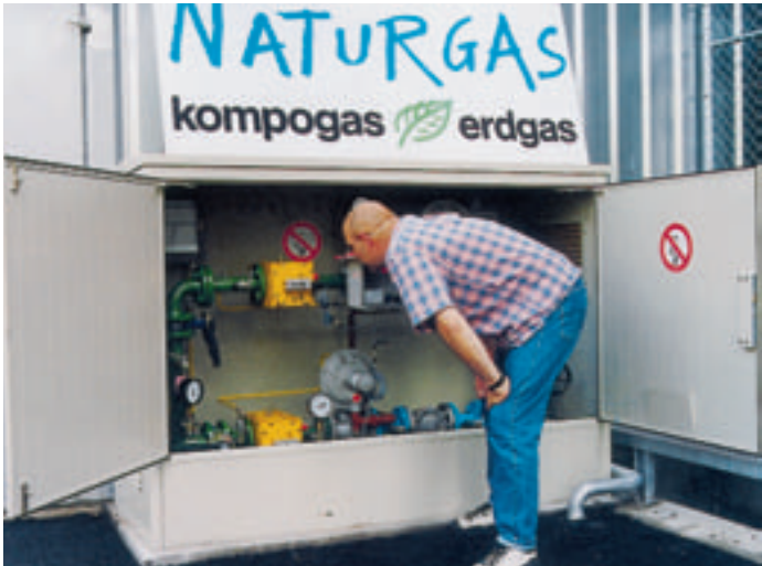
4.6 Seit 1996 wird Biogas, erzeugt aus Küchen- und Gartenabfällen, ins Zürcher Gasleitungsnetz eingespeist. Das «Kompogas»-Verfahren ermöglicht auch die Herstellung von CO 2 -neutralem Fahrzeugtreibstoff. Bild VSG.
