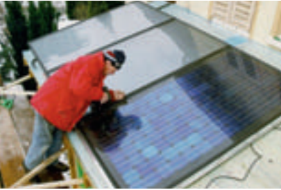
4.10 Kombianlage thermisch/photo- voltaisch, Solar-Compactline, 4,5 m 2 Kollektor und PV Anlage 2,25 m 2 , Deckungsgrad im EFH: 60% für Warmwasser, 7% für Strom. Bild SSES
