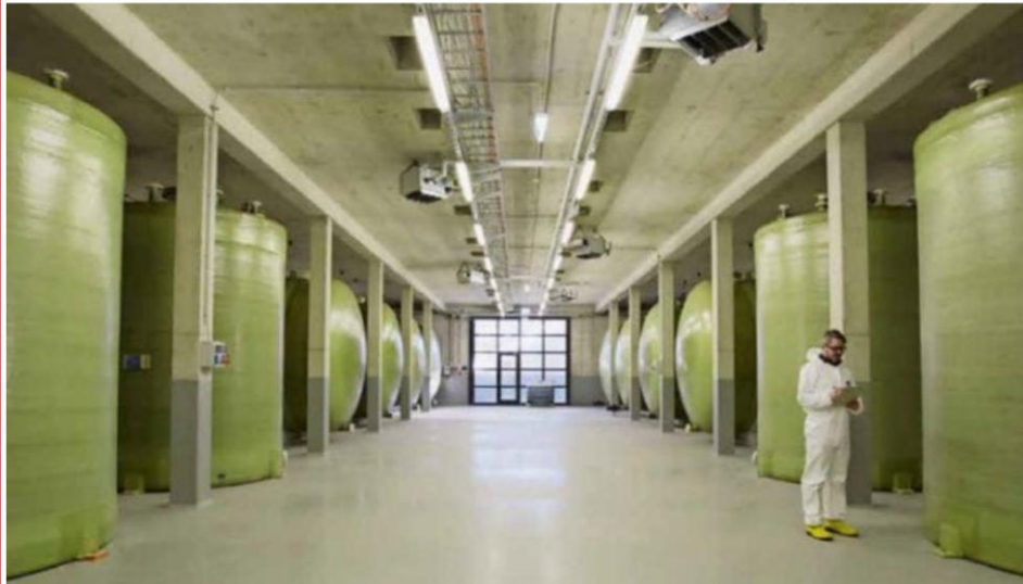
Redox-Flow-Batterie bei Fraunhofer in Dfrestel
